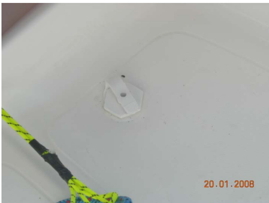
svuotatore visto dal pozzetto Il tappo di gomma è solidale con la guarnizione.
